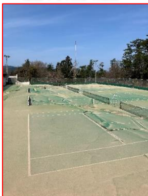
輪島中学テニスコート陥没
